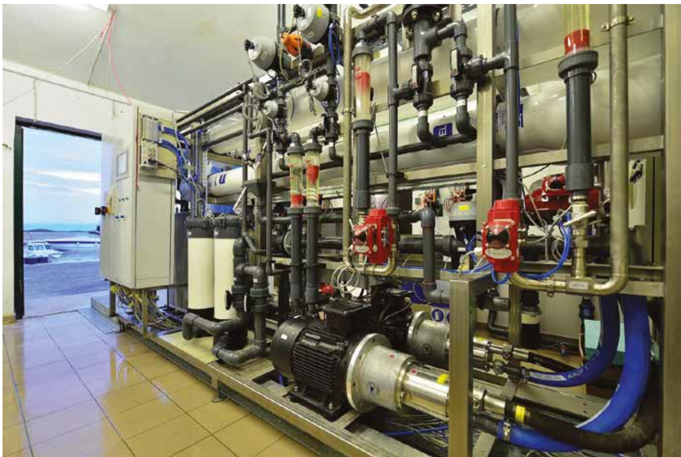
Naprava za reverzno osmozo v sklopu razsoljevalne naprave Susak
