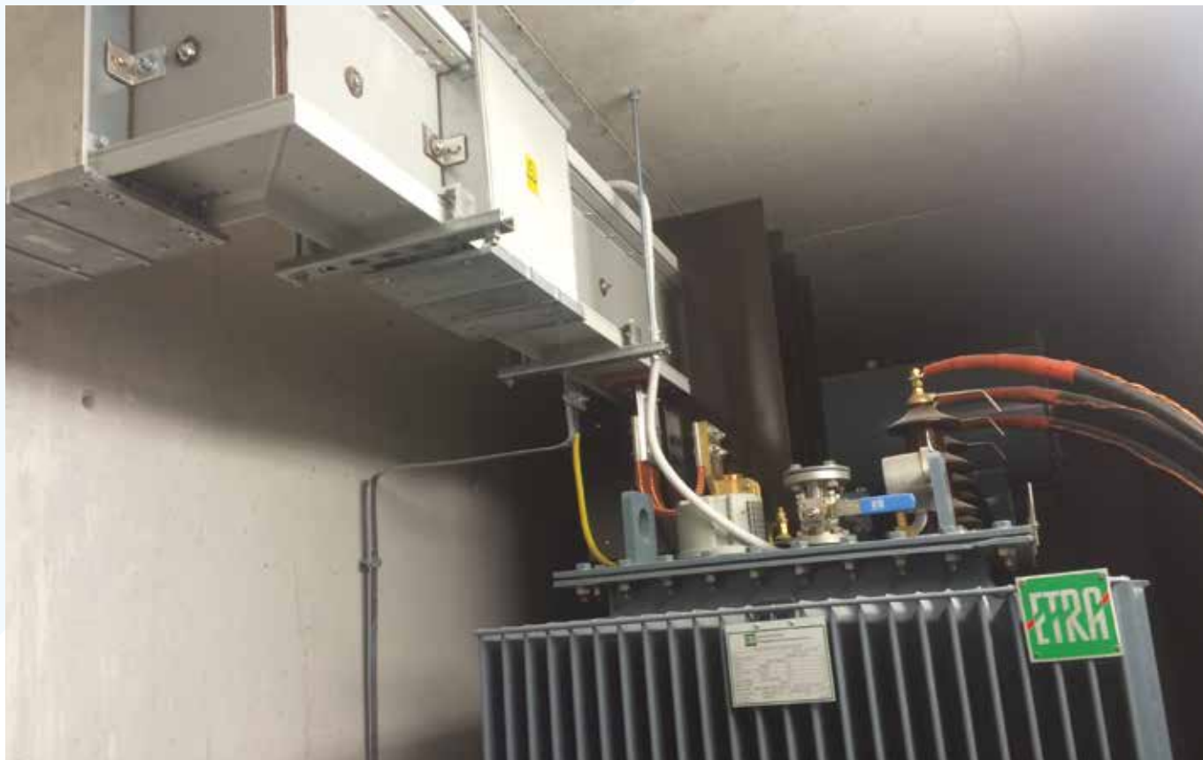
Slika 2: Transformator in zbiralni sistem
