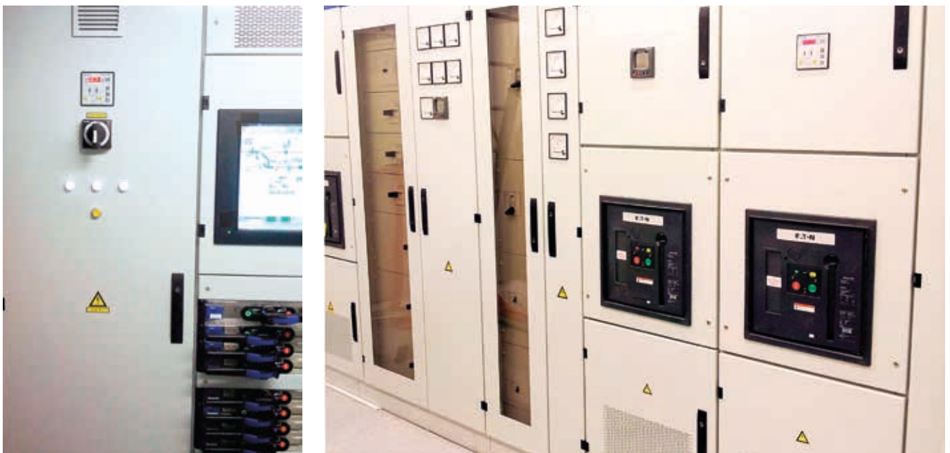
Slika 3 in 4 – Stikalni blok v eni izmed strojnic na objektu KZPS (levo) in stikalni blok za potrebe napajanja studia v objektu Telekom Stegne (desno) z vgrajenim avtomatskim preklopom napajanja.
