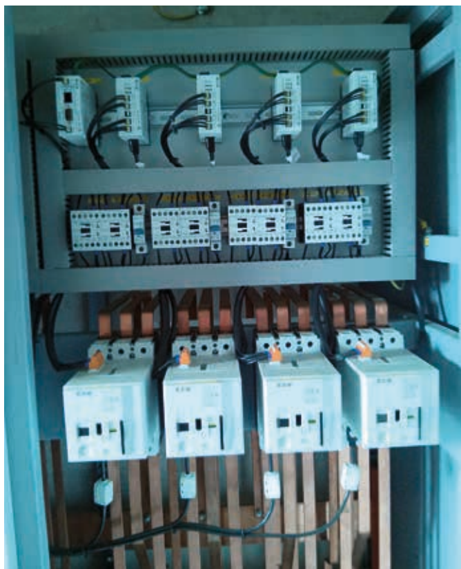
Slika 1 – Izgled NN stikalnega bloka z odklopniki krmiljeni po SmartWire komunikaciji
