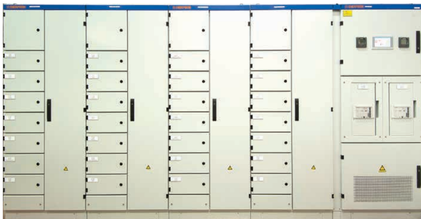
Slika 6 – Izgled stikalnega bloka xEnergy v SB Jesenice
