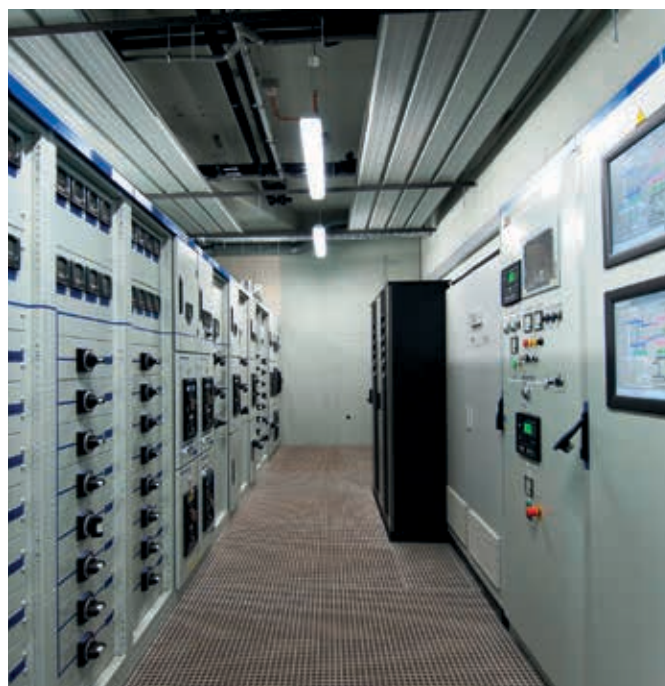
Slika 1 – Stikalni bloki xEnergy primarnega razvoda nizkonapetostne električne energije
