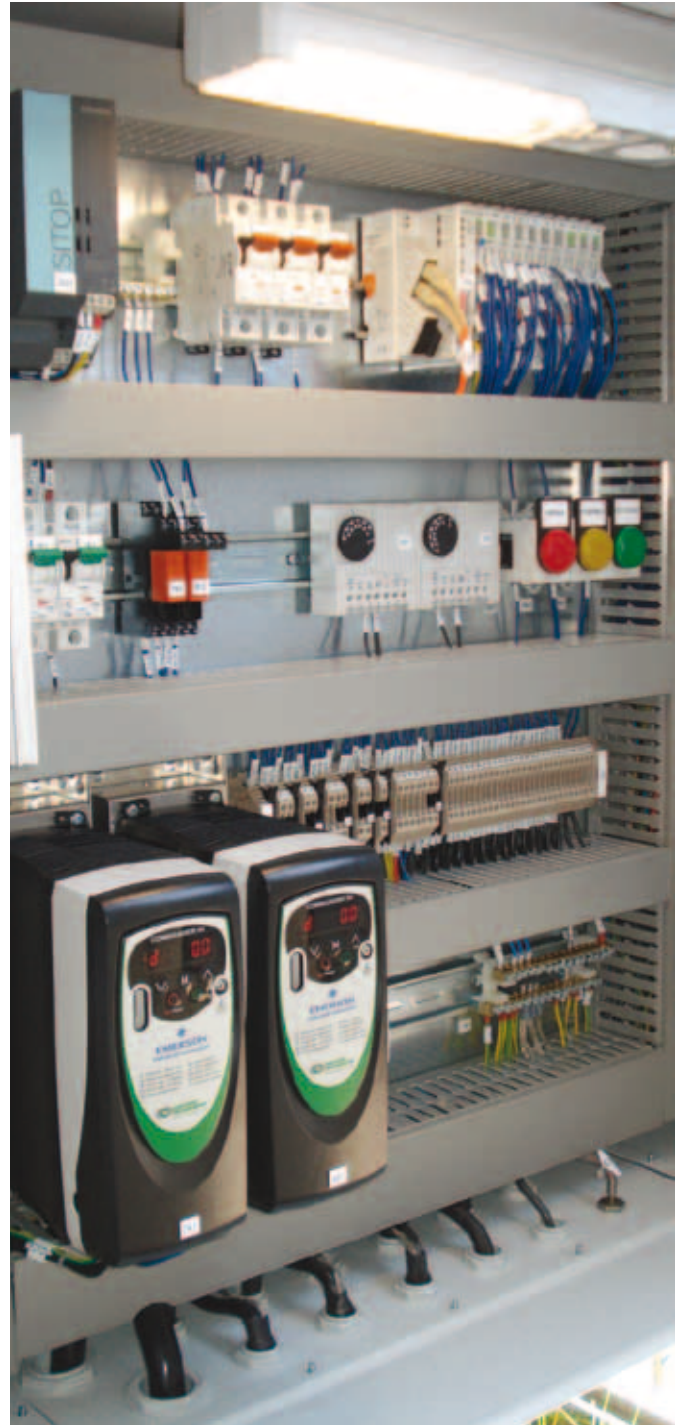
Slika 3 – Krmilni stikalni blok nadzornega sistema energetskega transformatorja – NSET
