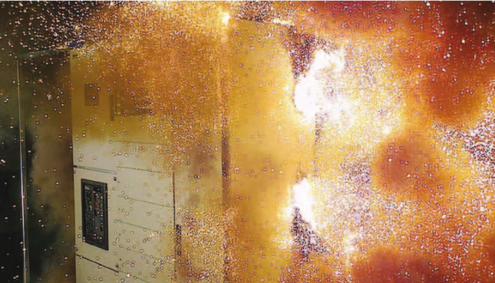
Slika 5 – Električni oblok v nizkonapetostnem stikalnem bloku
