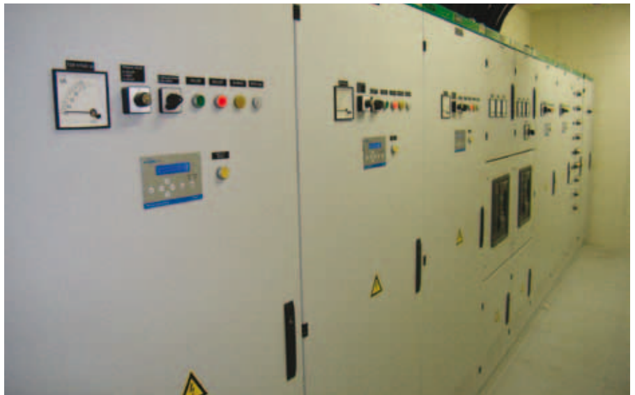
Slika 2 – Stikalni blok za napajanje drenažnih črpalk
